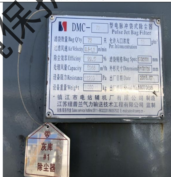
1#灰库除尘器铭牌
