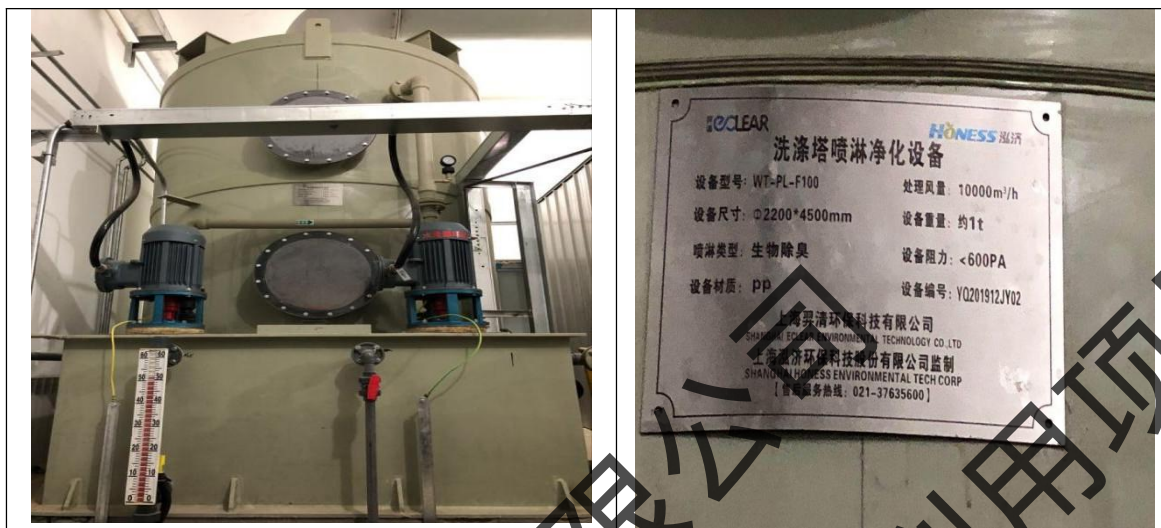
洗涤塔喷淋净化设备
