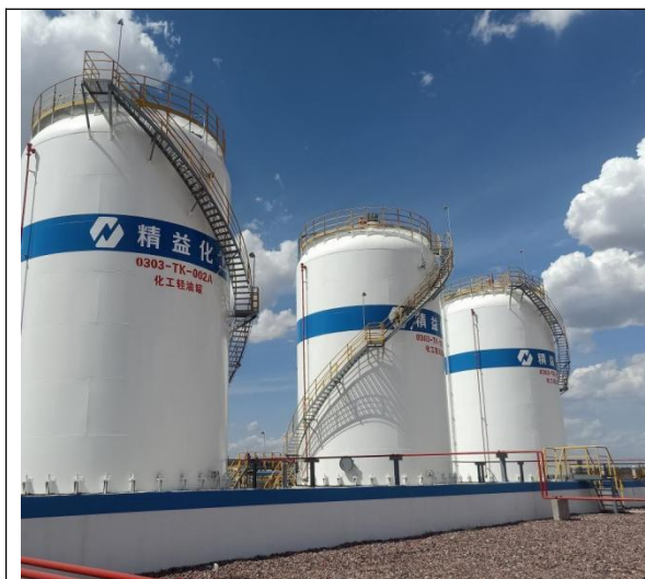
化工轻油罐区设置围堰
